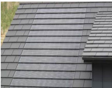
Dak met geïntegreerde pv-panelen
